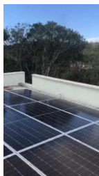
Peruíbe 0019 – Gerador Fotovoltaico de 9,81 kWp (aprox. 950 kWh/mês)
