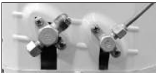
FIG. 26 - CONEXÃO DA LINHA DE EXPANSÃO DA UNIDADE CONDENSADORA
